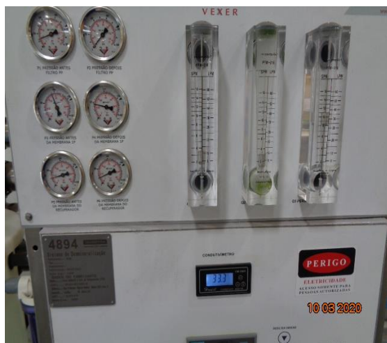
Figura 7 – Instrumentação utilizada no processo de osmose reversa.
