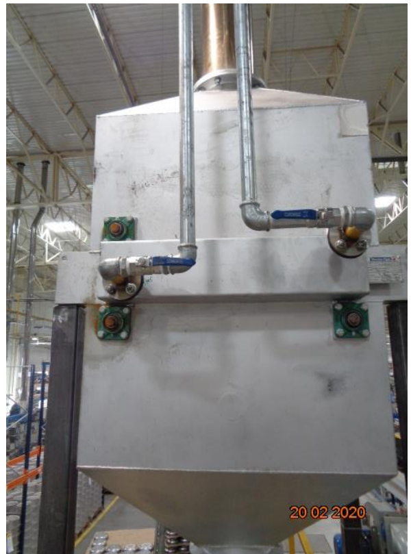
Figura 4 - Trocador de calor instalado e em funcionamento na chaminé.
