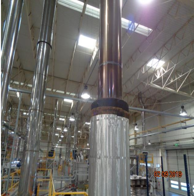
Figura 2 - Chaminé da estufa da máquina de lavar 1.
