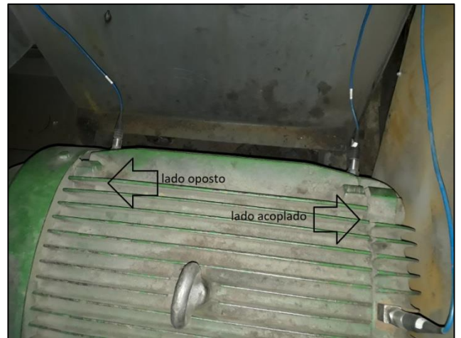
Fig. 9: Sensores instalados no motor
