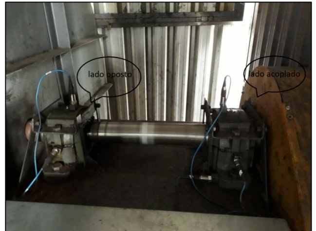
Fig. 8: Sensores instalados nos mancais
