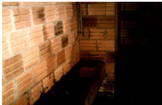
Figura 4: Mictório de um dos banheiros masculinos. Fonte: Foto do acervo de Airton Negrine (2010).
