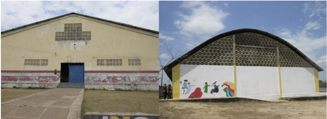
Figuras 7 e 8. Estado de conservação das quadras em São Bernardo/MA
