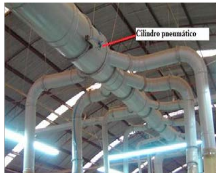
Figura 12: Damper automático com atuador pneumático (Maq. 0710).
