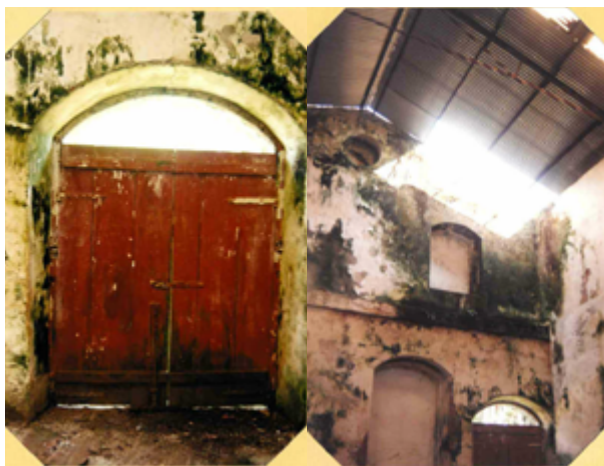
Figura 1 – Fotografia da área interna anexa ao processo de tombamento das ruínas da Usina do Duque de Aumale, datada de 2002.
