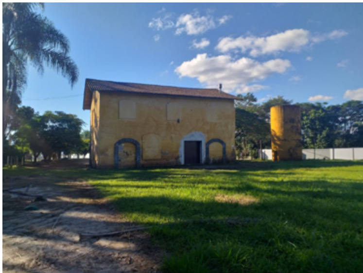
Figura 2 – Ruínas tombadas da Usina do Duque de Aumale em 2021, onde fica visível alteração estrutural de abertura de vão na fachada sul e utilização de cimento.
