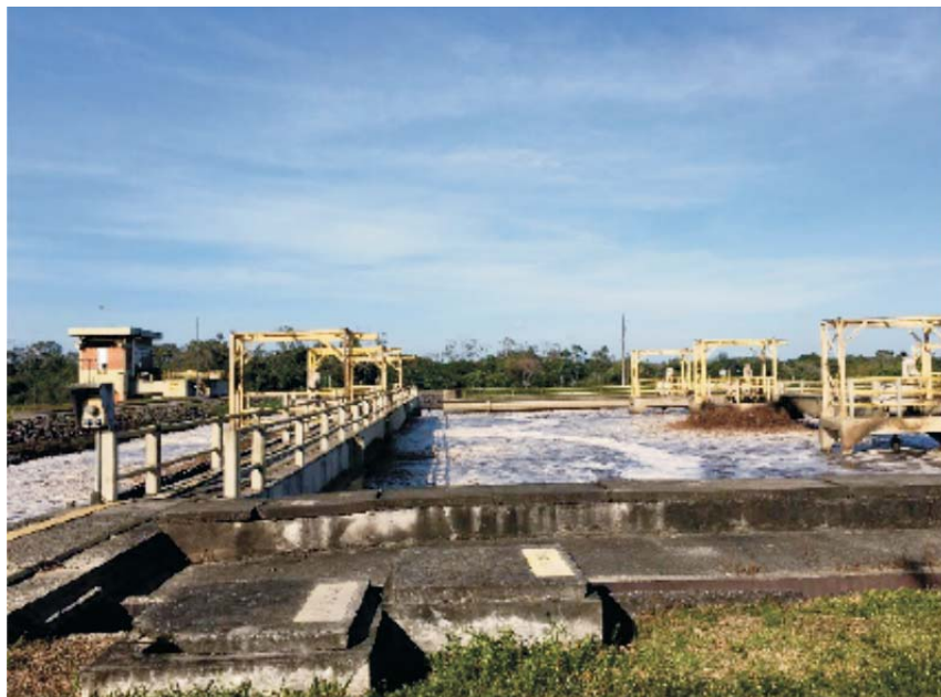
Figura 1 – Tanques de aeração da Cetrel – 2016
